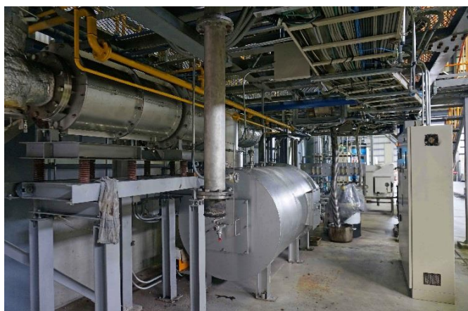
排ガス処理装置
